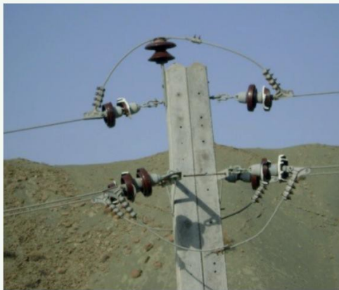
Figura 25: Isoladores danificados por DLS
