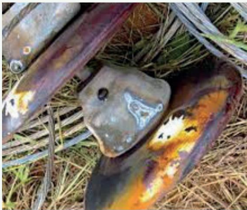
Figura 24: Isolador danificado por corrente de curto
