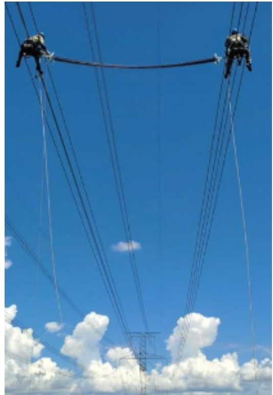
Exemplos de instalação de haste isolante espaçadora entre fases 500kV
