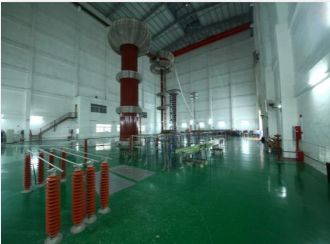
Gerador de Tensão a Frequência Industrial 1500 kV
